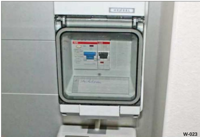
Mynd 23 Rafmagnsdreifingarkassi að innan
