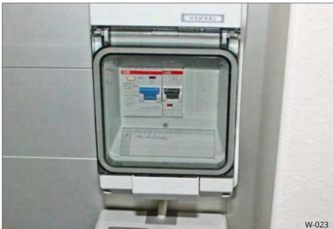
Sl. 23 Razvodna kutija za napajanje u unutrašnjosti
