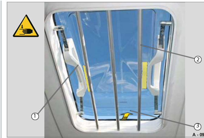
Slika 99 Odprto strešno okno (v smeri vožnje)
