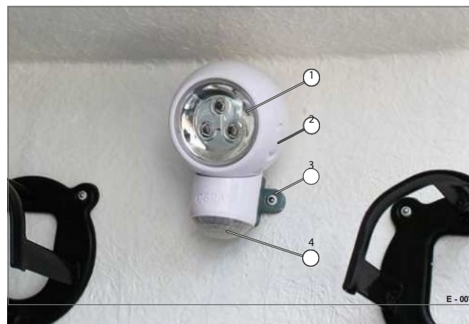
Rys. 7 Oświetlenie LED z czujnikiem ruchu
