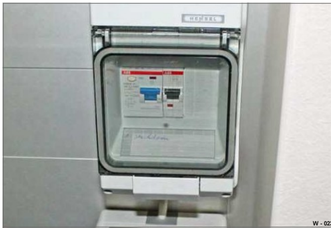
Rys. 23 Wewnętrzna skrzynka rozdzielcza zasilania
