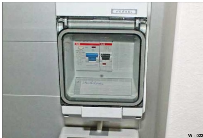
Obr. 23 Rozváděč napájení v interiéru
