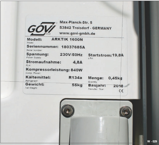
Fig. 5 Exempel: Identifiering av kylaggregat
