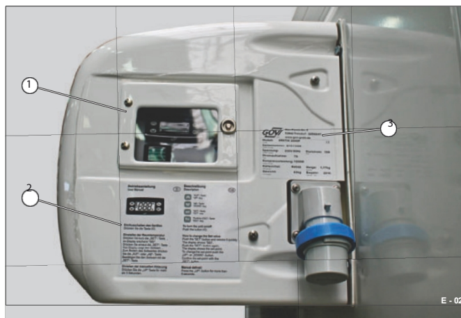
Fig. 21 Lado de funcionamento da unidade de arrefecimento
