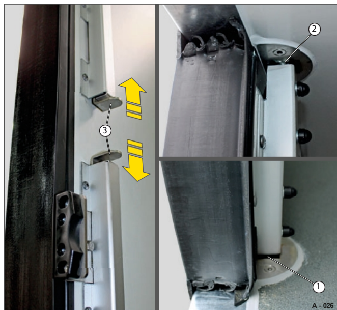
Rys. 26 Zablokowany mechanizm blokujący skrzydło drzwi
