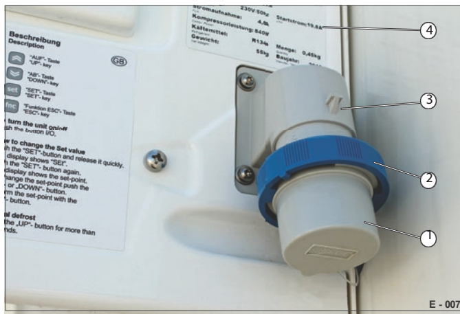
Fig. 8 Nettilkobling (på utsiden av kjøleaggregatet)
