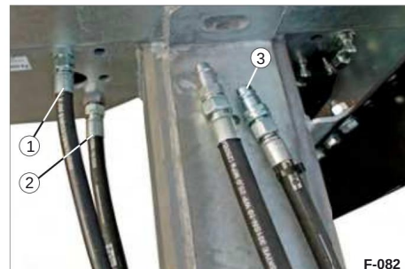
Fig. 33 Hydraulikledninger til traktor
